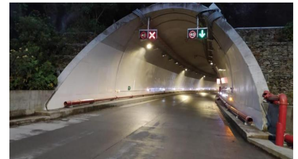
CONTROL VENTILACIÓN TÚNEL DE GUALANDAY
