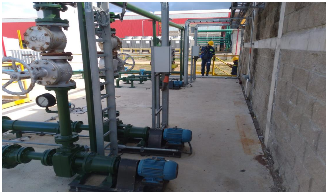
CONTROL DE NIVEL POZOS DE AGUA - TERNIUM
