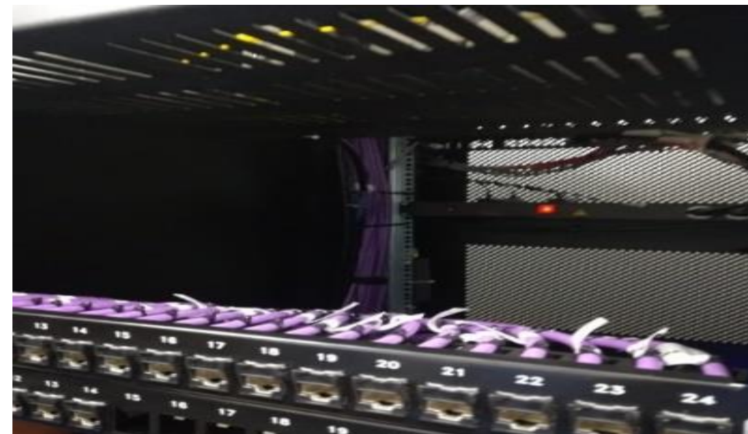
DISEÑO E INSTALACIÓN CABLEADO ESTRUCTURADO Y DATA CENTER EDIF. PRINCIPAL – BANCO DE OCCIDENTE
