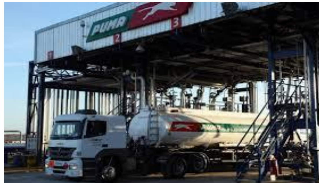
AUTOMATIZACION PLANTA DE COMBUSTIBLE
