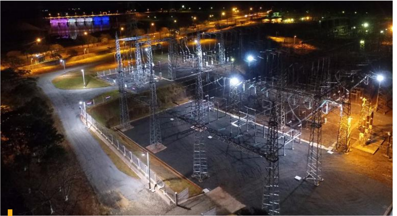
Estación de 220KV | Presidente Franco
