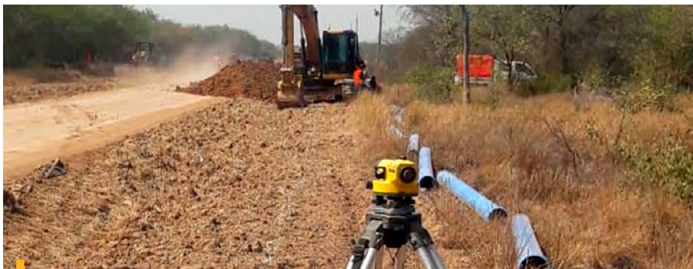
Construcción de redes de abastecimiento de agua potable a comunidades indígenas y localidades menores beneficiarias del proyecto del Acueducto del Chaco Central
