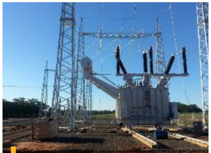
Instalaciones de Subestación | Santaní
