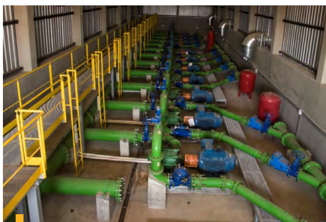
Estación Central de bombeo | Loma Plata
