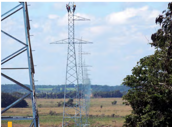
Torres de transmisión 220 KV | Santaní
