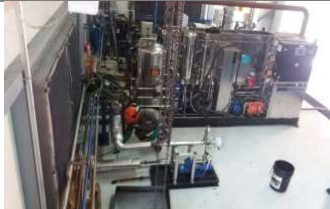
Operación de equipo de tratamiento de aguas oleosas SENITEC
