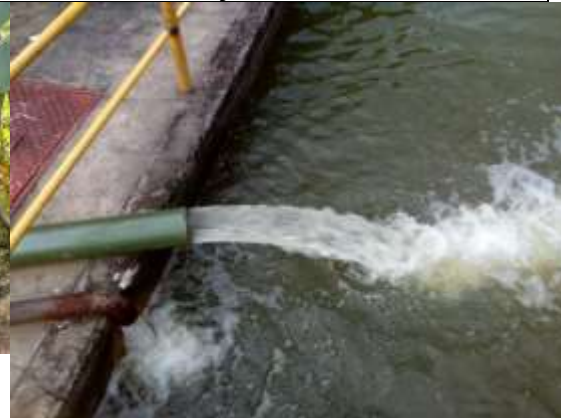
Sistema operando normalmente
