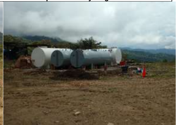
Bateria de tanques de combustible para la CT
