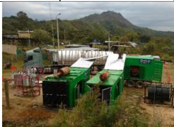
Descarga de los tanques en la central
