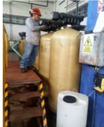
Mantenimiento de cabezales del tren de ablandamiento
