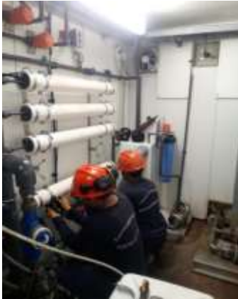
Mantenimiento de equipo de osmosis inversa
