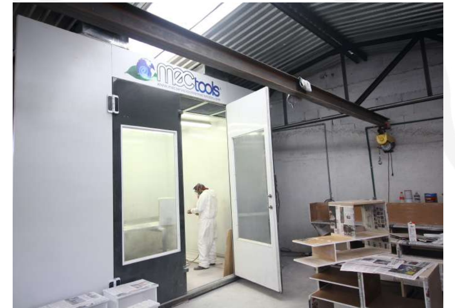
Cámara de Pintura
