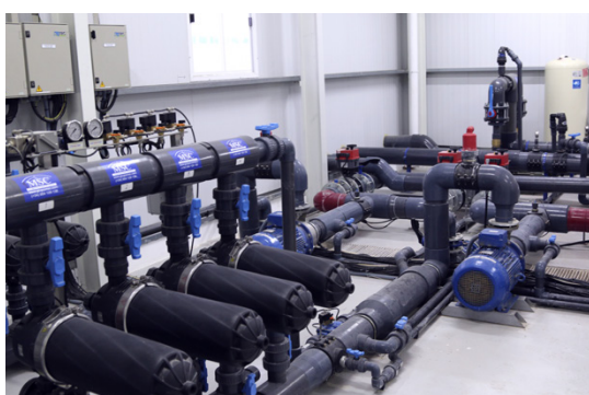
SISTEMAS DE FERTIRRIGACIÓN IRRIGATION SYSTEM
